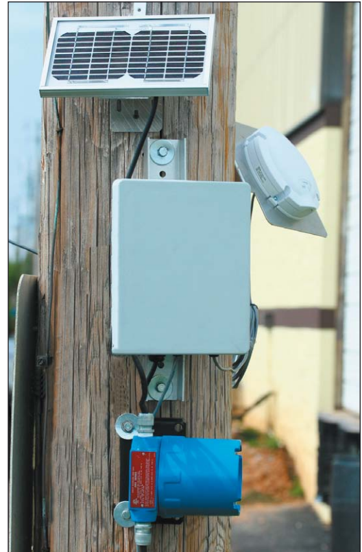
Sistema telemétrico de monitoreo remoto de la corrosión, con panel solar
